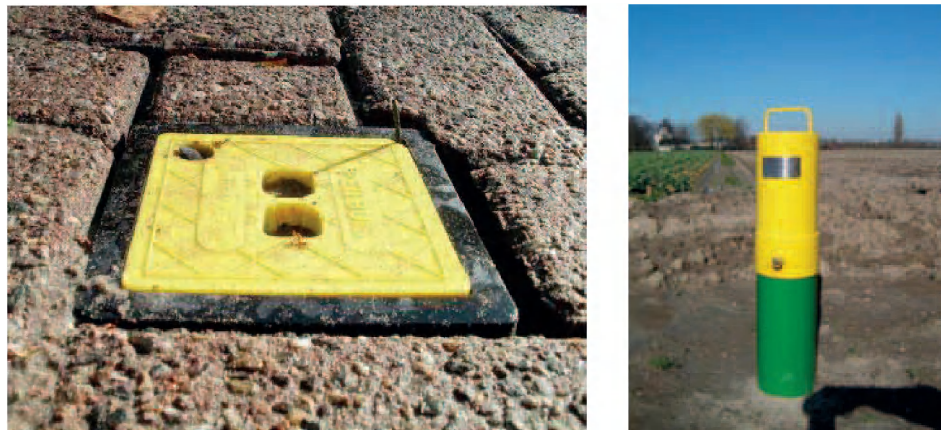
FIGUUR 3.2 AFWERKING VAN EEN PEILBUIS DOOR MIDDEL VAN EEN SCHUTKOKER (RECHTS, BRON: WILLEMSSEN, J., WATERSCHAP HOLLANDSE DELTA) EN STRAATPOT (LINKS, BRON: WARECO)
