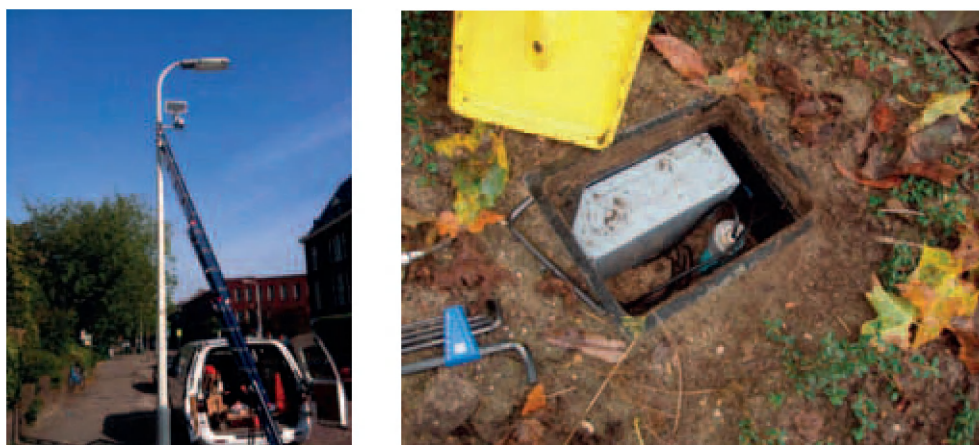
FIGUUR 4.8 TELEMETRIE GEÏNSTALLEERD IN STRAATPOT (RECHTS) EN ROUTER (LINKS) (BRON: WARECO)
