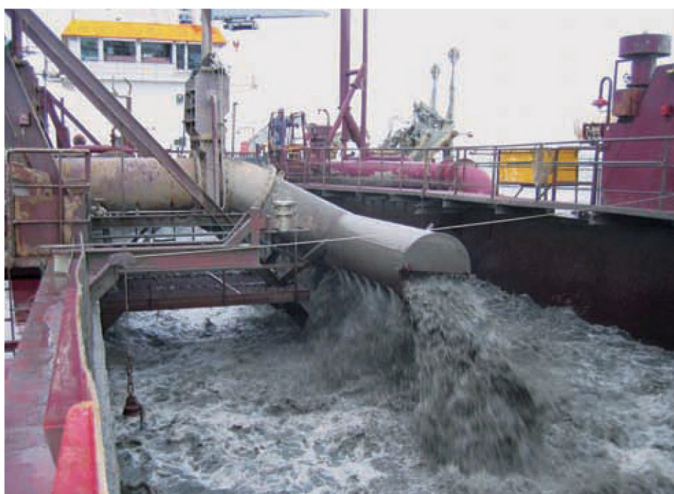
■ Het opgezogen mengsel van water en zand komt terecht in het beun van het baggerschip (BV)
