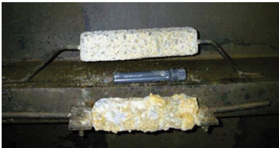
■ Door in de ballasttanks op regelmatige en goed gekozen plaatsen blokken minder edel metaal (bv. zink of aluminium) of "opofferingsanodes" aan te brengen en die elektrisch te verbinden met de te beschermen wanden, wordt corrosie afgeremd (HZS)
