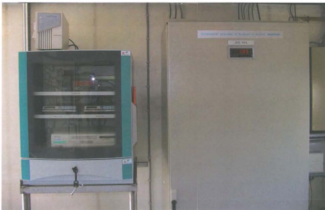
Teletransmissie & telecommunicatie te Oostende
