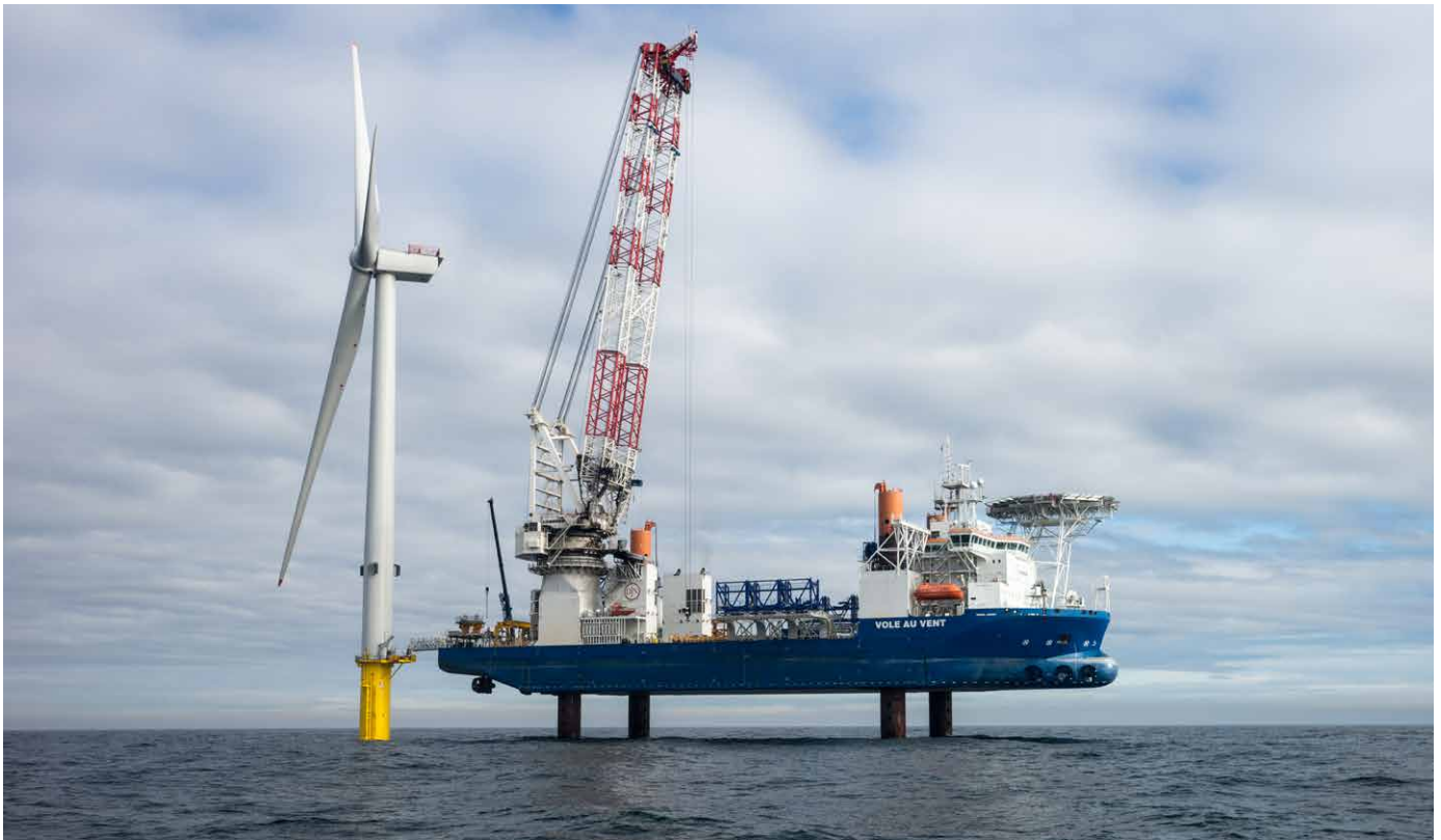
De kraan van het offshore jack-up installatieschip Vole au Vent (Jan De Nul) laat toe om op een veilige manier zware funderingen en componenten van offshore windmolenparken te installeren. © Haven Oostende
