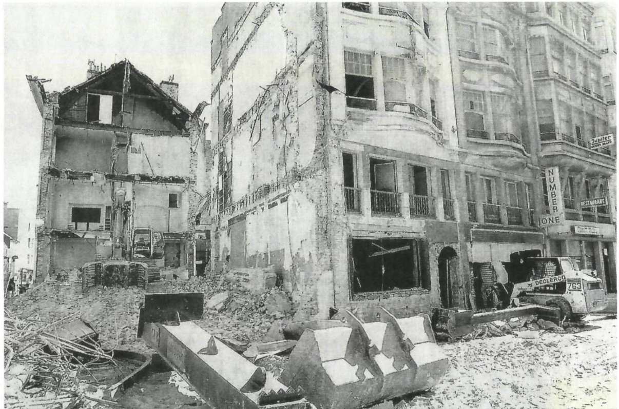
De sloop van de woningen in de Van Iseghemlaan 40 — twee ex-bordelen — werd stopgezet wegens asbest rond de leidingen in de verwarmingsruimte. © Els Verhaeghe
