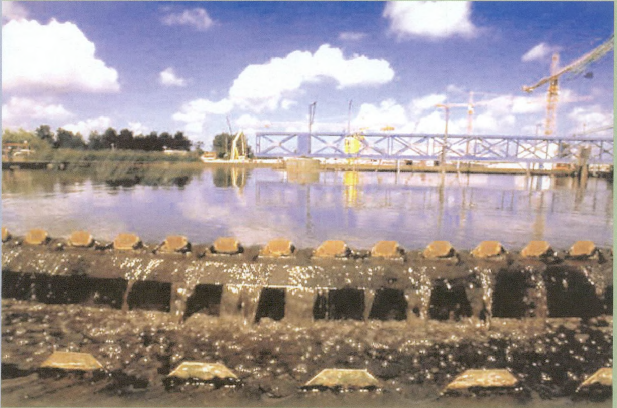
Nabezinktank van de RWZI te Brugge
