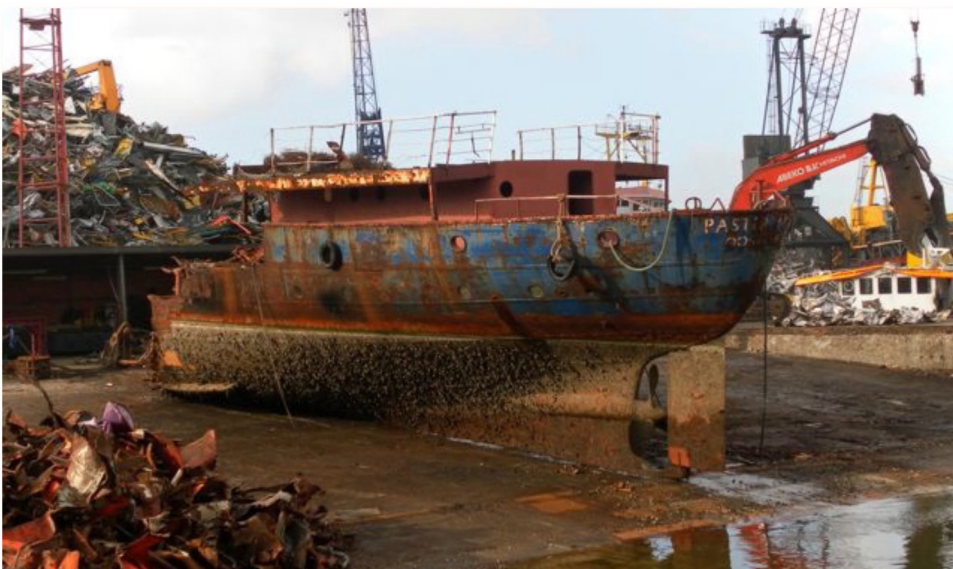
Een laatste blik op achtersteven van de Paster Pype, reeds voor de helft gesloopt. Uiterst rechts zie je ook nog een restant van de brug van de Zeearend onder de sloopschaar.
