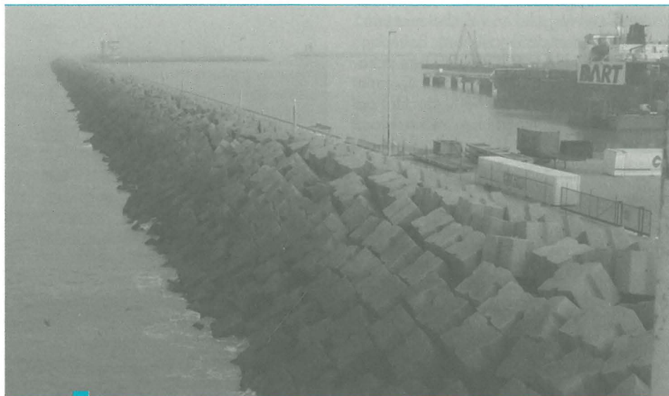
BV Gegroefde kubusvormige betonblokken vormen de deklaag van een deel van de westelijke strekdam te Zeebrugge
