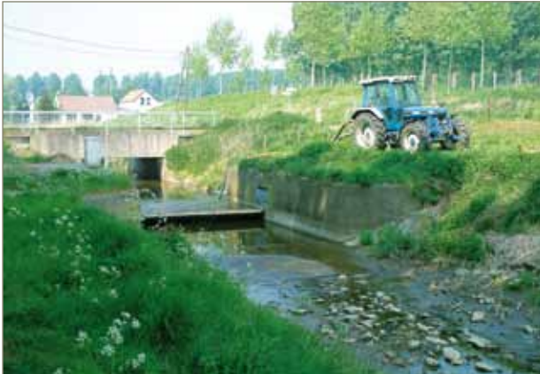
figuur 23: Stuw op de Noord-zuidverbinding, waar net de stuw de landbouwers bij droogte oppervlaktewater afpompen
