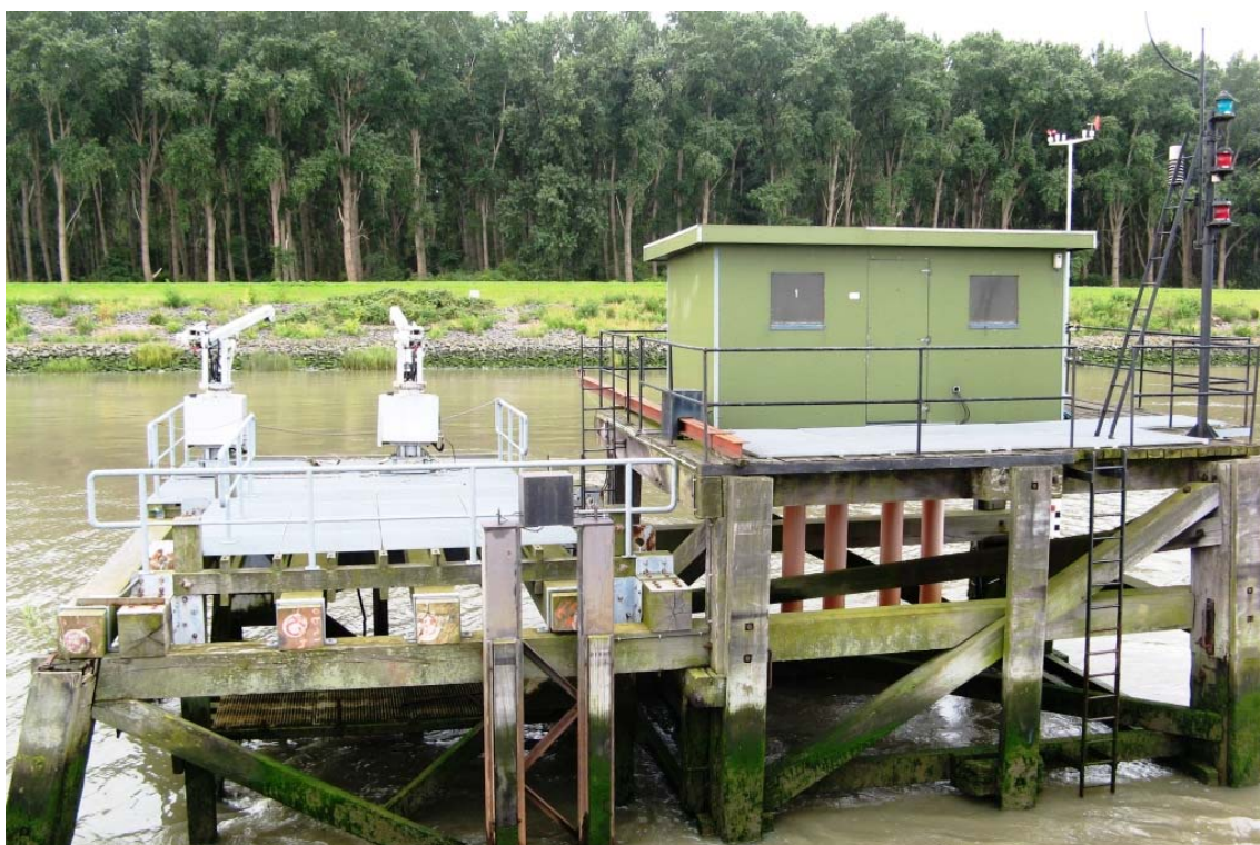
Figuur 118 - Beneden-Zeeschelde te Oosterweel: foto van de meetdukdalf met aan linkerkant (opwaartse zijde) de twee kranen elk dragend een Aanderaa-RCM9-meettoestel en aan rechterkant (afwaartse zijde van de dukdalf) de meethut met tij- en meteo-meting
