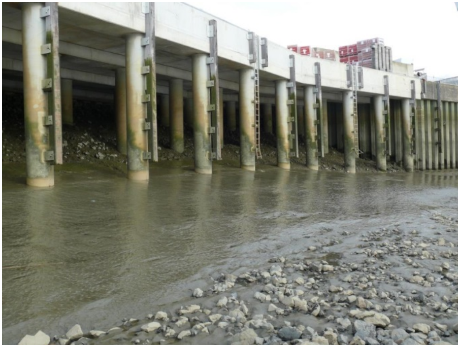
Figuur 3 – Sedimentatie ter hoogte van de overgang tussen de nieuwe en oude kaaimuur
