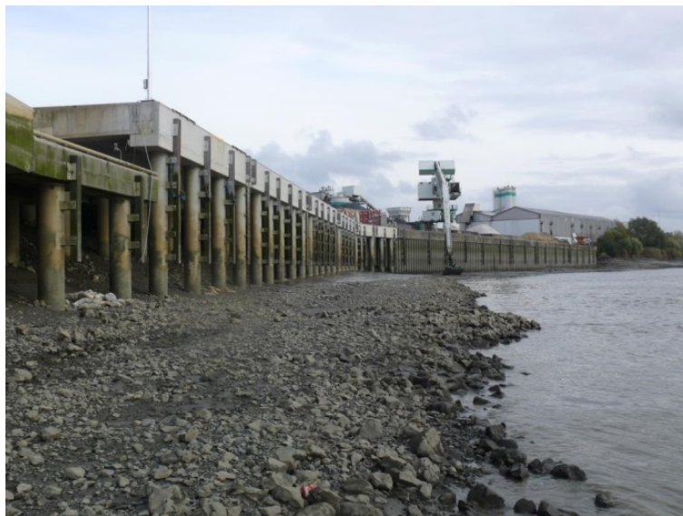
Figuur 1 – Strandingsbank bij laagwater ter hoogte van nieuwe kaaimuur
