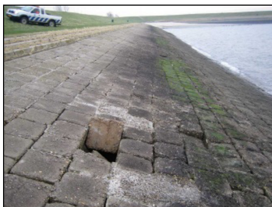
Figuur 5. Voorbeeld van schade (Bron: project zeeweringen, 2007).
